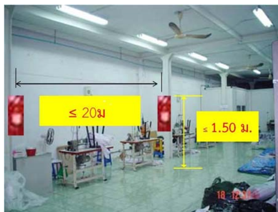
รูปที่ 6.1.15 การติดตั้งเครื่องดับเพลิงแบบมือถือ
